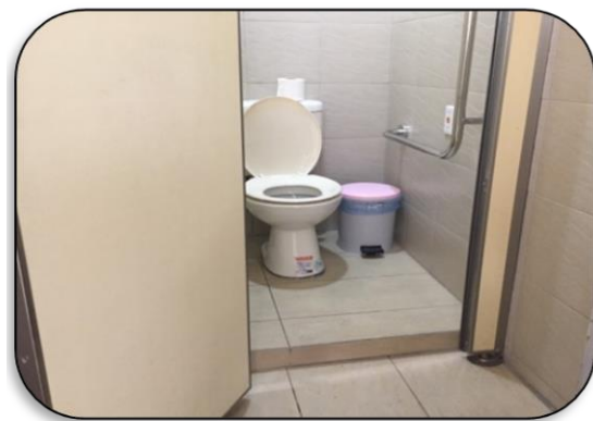
部分無障礙廁所出入口淨寬不足或設有門檻
