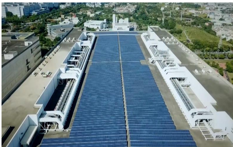
圖 12 科學園區屋頂型太陽光電
