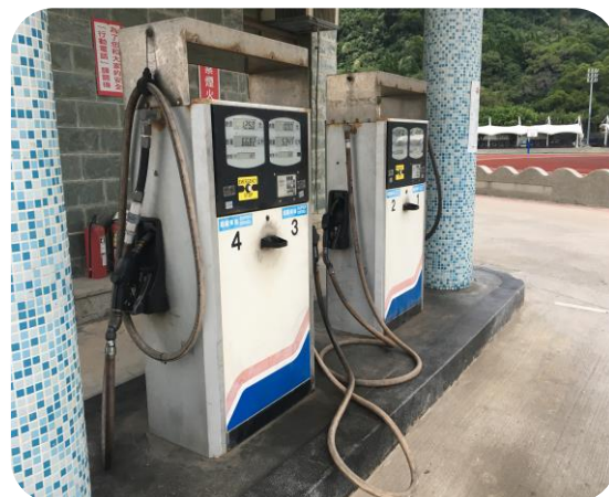
圖 3 福澳加油站油管散落車道情形
