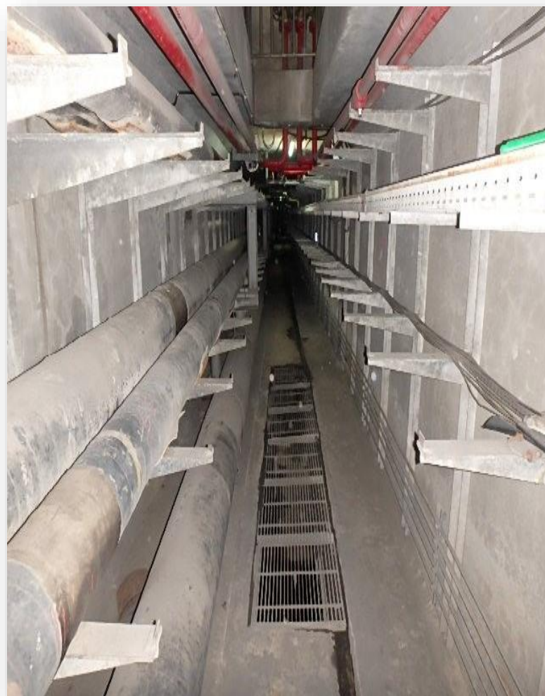
民族路共同管道內部空間情形
