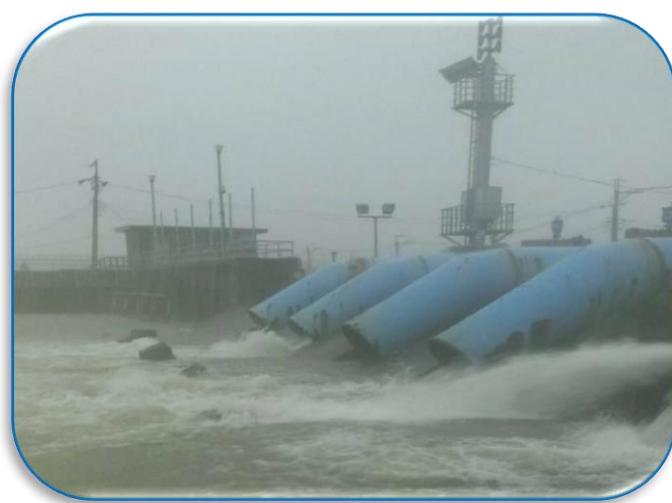
尼莎颱風侵襲，放索溝抽水站運轉排除積水
