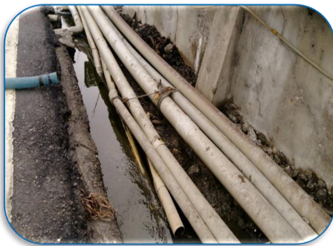
排水設施因塞滿管線而失去排水功能
