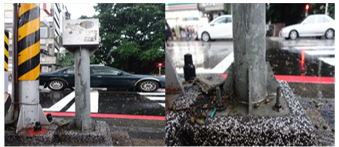
圖 1 交通號誌基座螺栓安全護套缺漏
