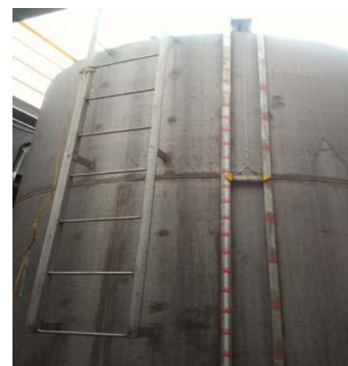
桃園市桃園區火化場油槽
