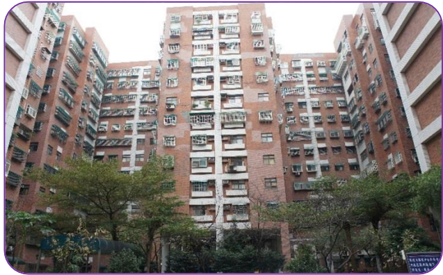
桃園市陸光四村外牆磁磚脫落情況嚴重
