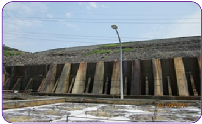
高雄市燕巢區掩埋場擋土牆裂縫滲水
