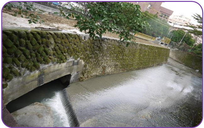
新竹市H幹線雨水下水道排水口迴水情形
