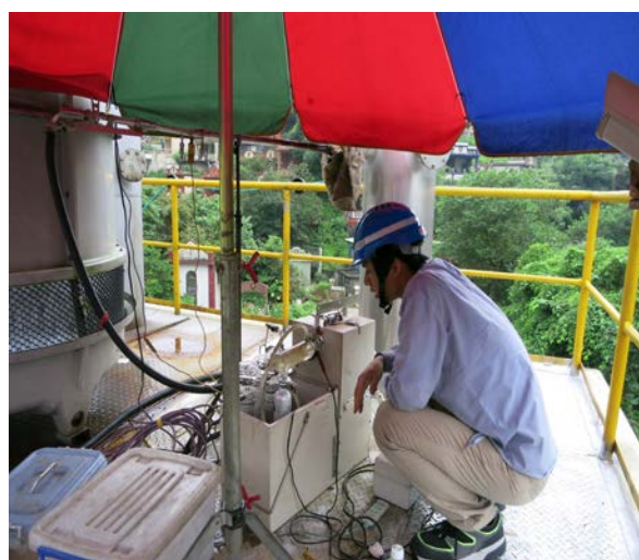
基隆市立殯葬管理所火化爐設備檢測情形 (基隆市環境保護局提供)
