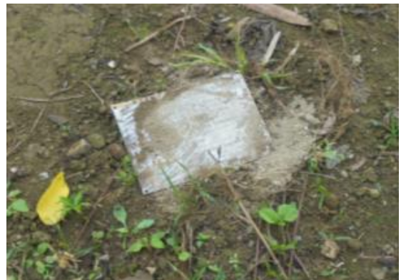
花蓮縣地下水監測井損毀情形 (花蓮縣環境保護局提供)
