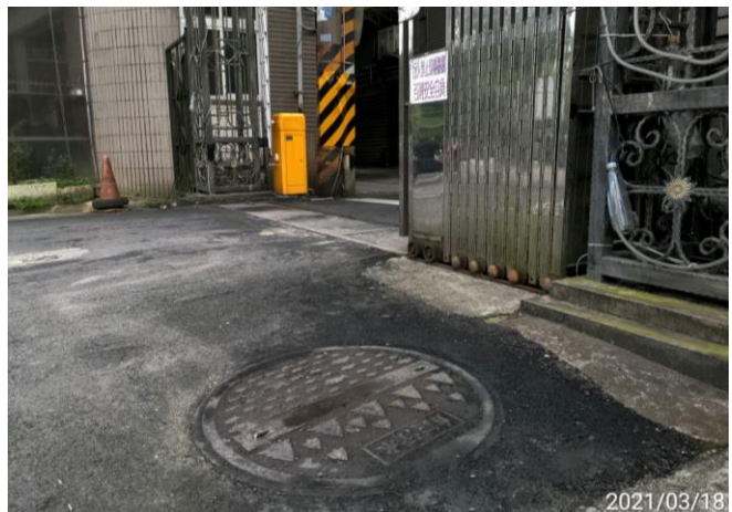
基隆市社區專用污水下水道 （基隆市環境保護局提供）
