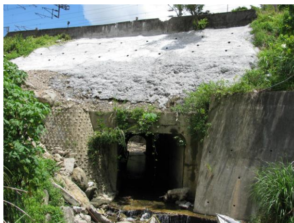
宜蘭線九份坑溪涵洞 23K+200 改建 工程-解除契約後現況 (101 年 9 月 4 日拍攝)
