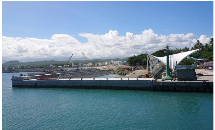
臺東縣富岡港交通船碼頭改善計畫水域工程施工情形 (110年10月6日自行拍攝)
