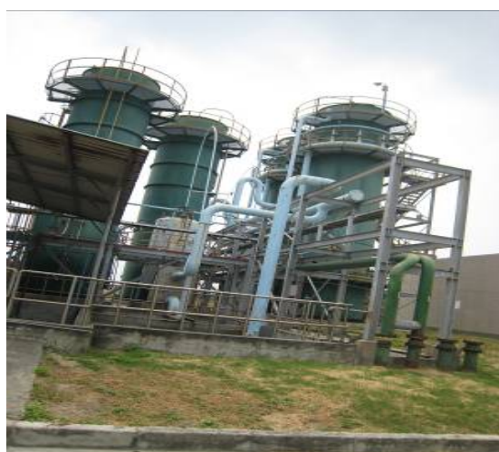
活性炭吸附塔裝置(停用) (高雄市政府經濟發展局提供)
