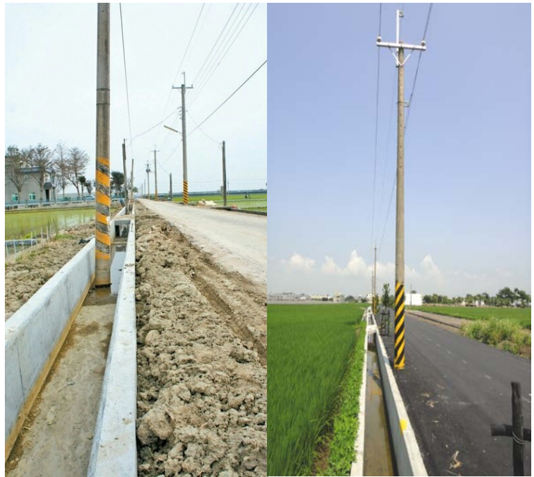
電線桿未遷移
