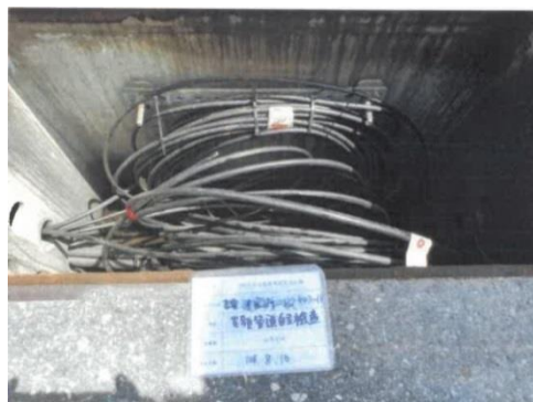
花蓮縣纜線暫掛於箱涵情形 (花蓮縣政府提供)
