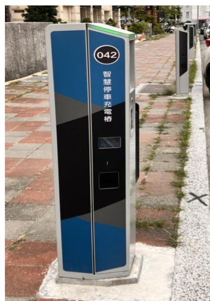
臺南市路邊智慧停車充電樁 (113 年 5 月 15 日自行拍攝)
