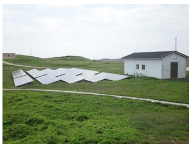
東吉嶼太陽光電發電設備 (海洋國家公園管理處提供)
