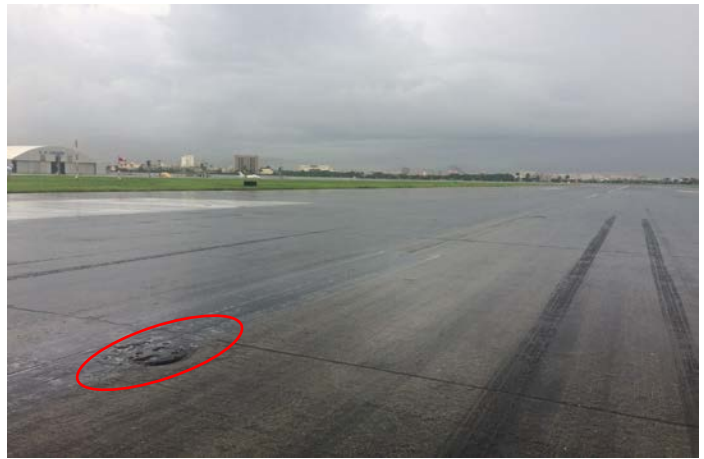
高雄機場跑道混凝土剝離損壞情形 (105年9月8日拍攝)
