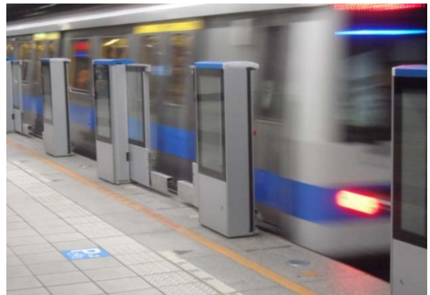
臺北捷運新埔站月台門建置情形 (103年9月13日拍攝)
