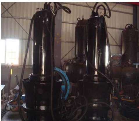
圖 3 整修完成之沈水式抽水機(水利局攝於 101 年 6 月提供)
