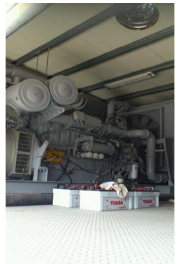
圖 2 安置港尾溝之發電機(水利局攝於 101 年 1 月)
