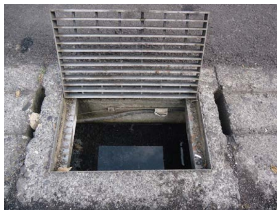
南投縣南投市雨水下水道附掛纜線 (南投縣南投市公所提供)
