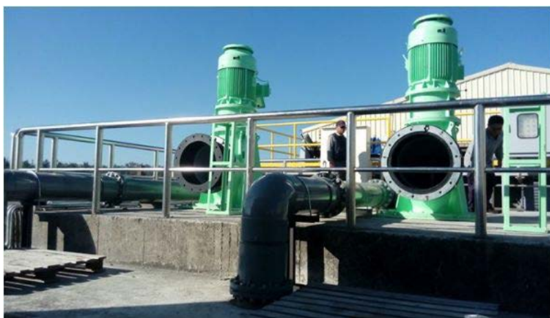
臺南市馬沙溝抽水站 (臺南市政府水利局提供)
