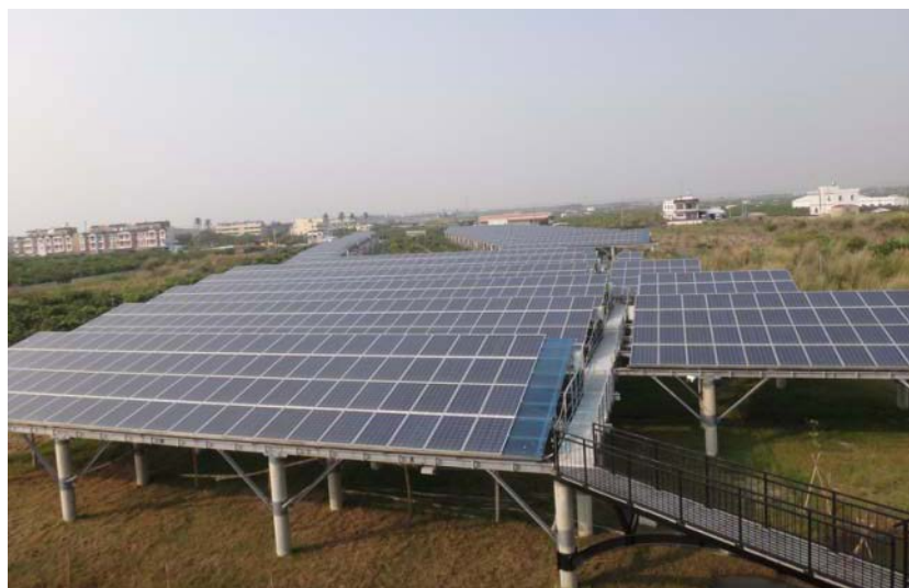
屏東地區太陽光電發電系統設置情形
