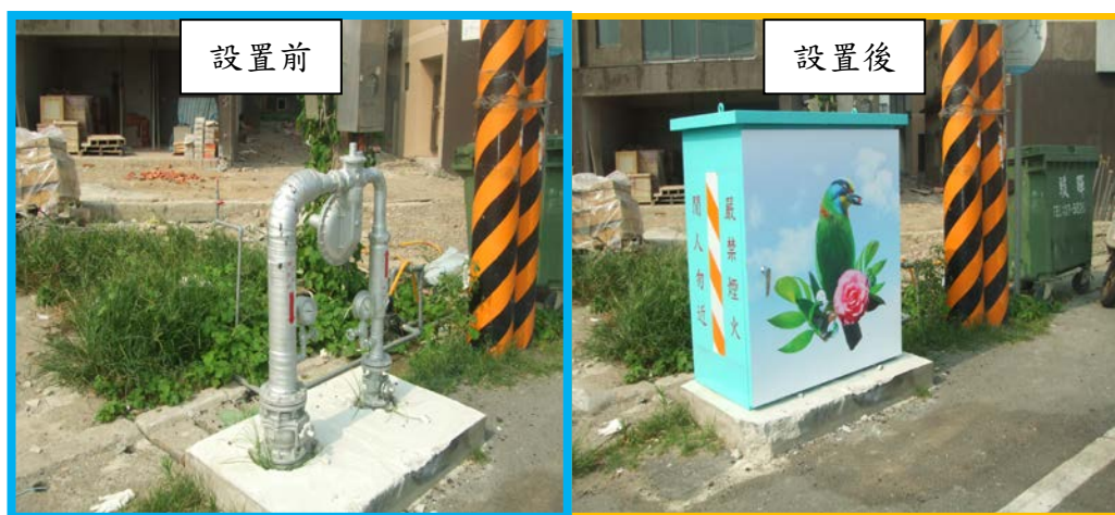
新竹縣路邊天然氣減壓設備防護箱設置情形 (新竹瓦斯股份有限公司提供)
