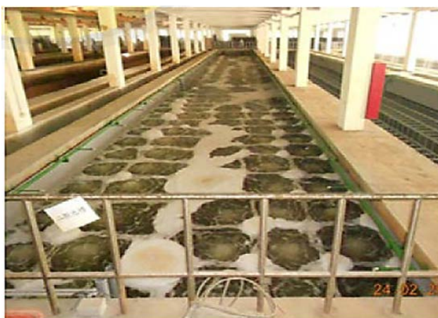
高雄市岡山本洲污水處理廠曝氣池設施 (高雄市政府經濟發展局提供)
