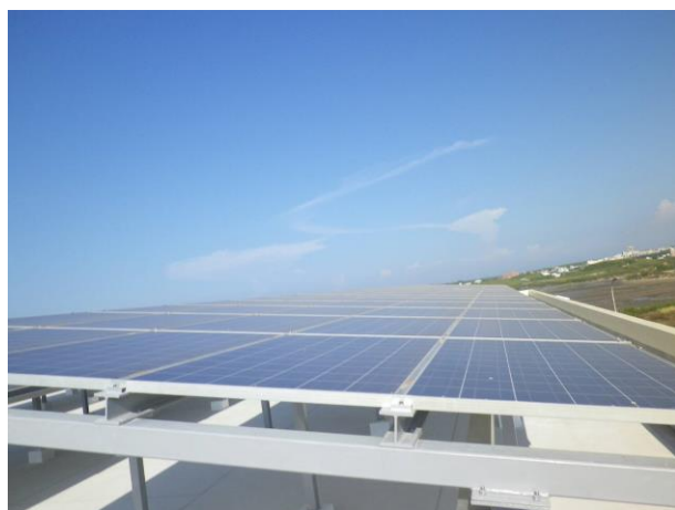
太陽光電設備 （國立澎湖科技大學提供）
