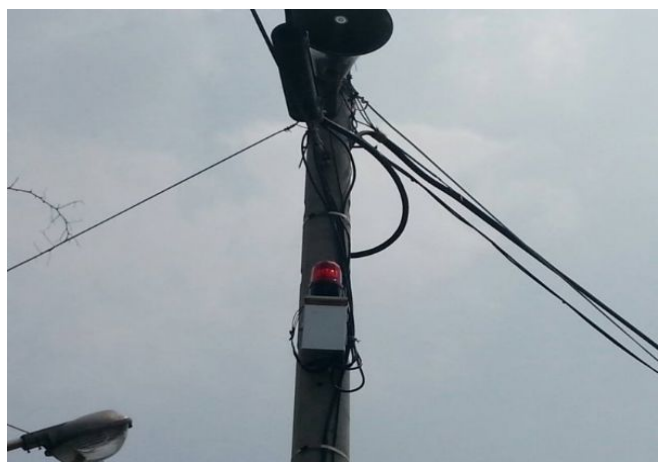
臺南市新化區水位警戒燈設置情形 (臺南市政府水利局提供)
