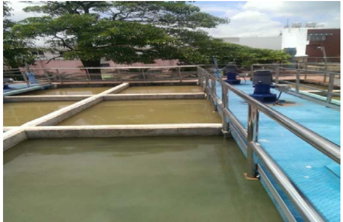
大湳淨水場膠羽沉澱池設備改善鋁含量情形 (台灣自來水公司提供)
