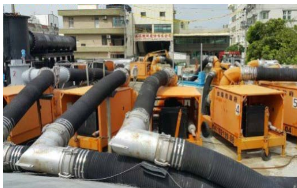
臺南市崑山抽水站完工前暫置之應急 移動式抽水機
