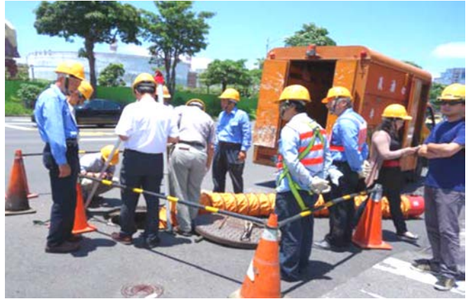
高雄市天然氣輸儲設備安全檢查執行情形 (高雄市政府經濟發展局提供)
