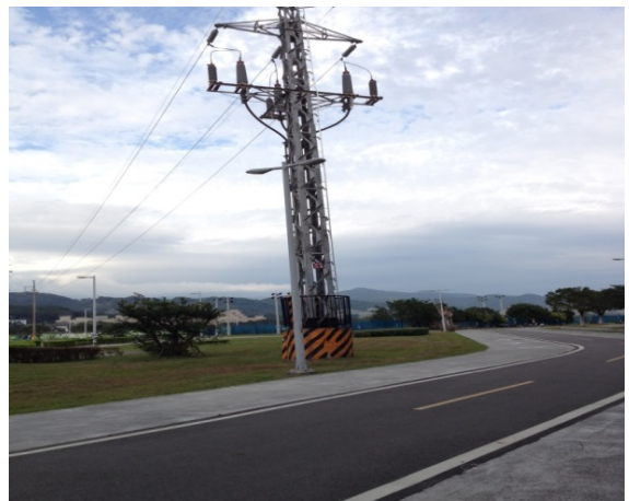
臺北市河川區域設置之電塔 (臺北市政府工務局水利工程處提供)
