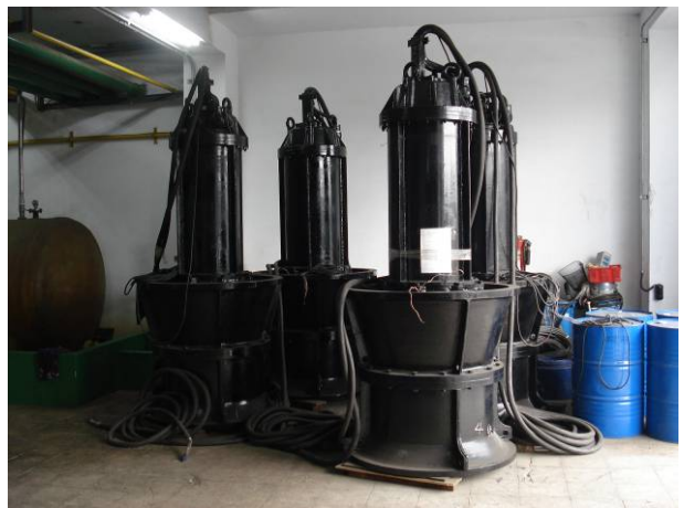
4組沉水式抽水機組 (100年6月16日拍攝)
