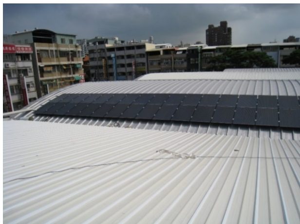
武廟市場屋頂之太陽能光電設備現況 (高雄市政府經濟發展局提供)
