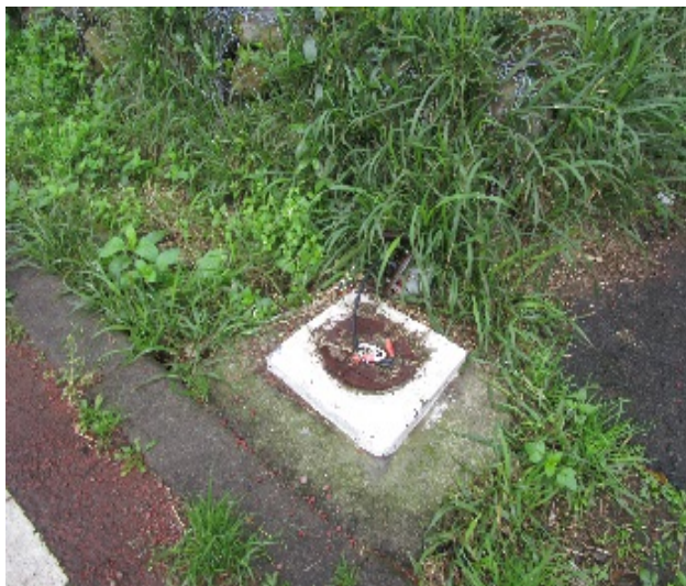
新竹市頭前溪自行車道景觀照明矮燈損毀圖 (105 年 2 月 24 日攝)
