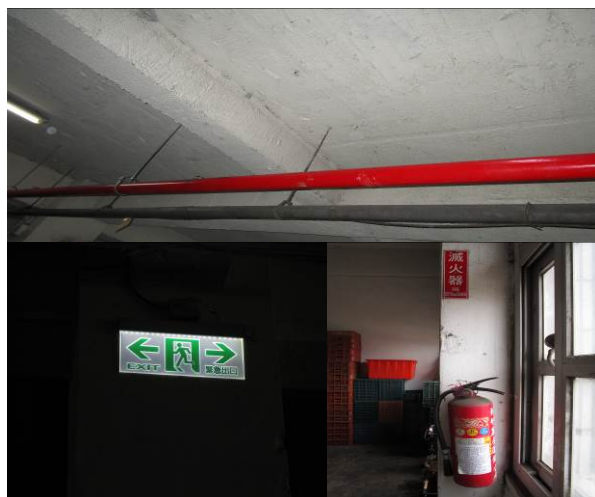
新竹農產運銷股份有限公司消防設備改善情形 (105 年 9 月 13 日攝)
