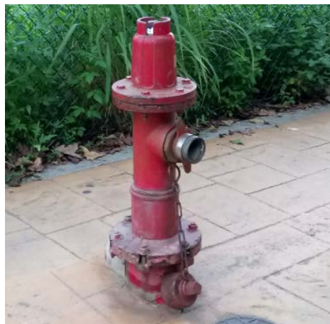
新竹縣轄區內已修復之消防栓 (105 年 9 月 9 日實地拍攝)
