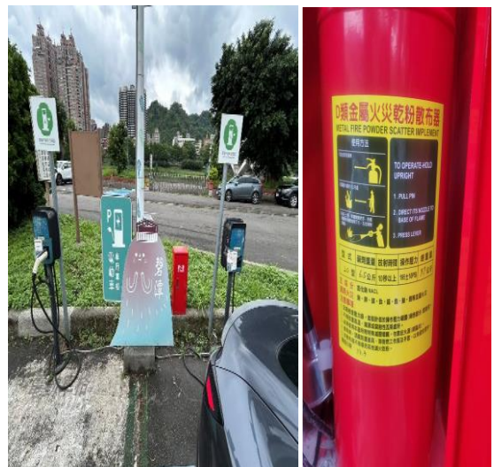
新北市碧潭風景區停車場電動車專屬消防設備
