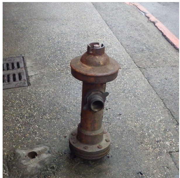
基隆市境內消防栓 (基隆市消防局提供)
