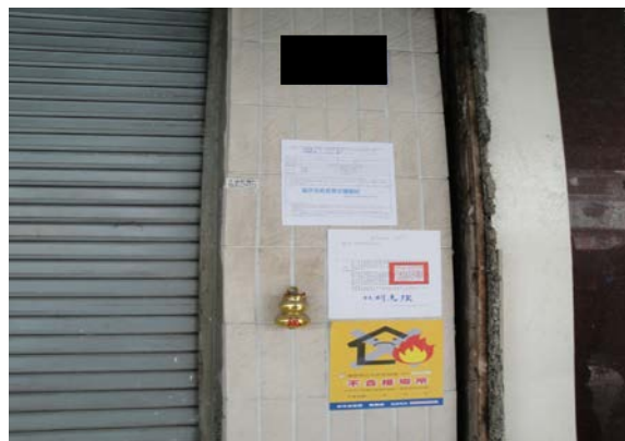
不合格場所標誌張貼情形 （臺中市政府都市發展局提供）
