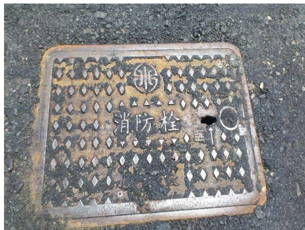
花蓮縣境內消防栓 （花蓮縣消防局提供）
