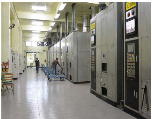
高雄市殯葬管理處第一殯儀館火化設施(改善後) (高雄市殯葬管理處提供)
