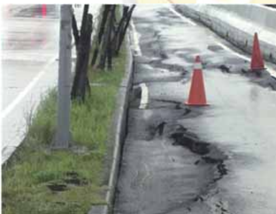
資料來源：高雄市政府工務局新建工程處提供。 圖 3 路側擋土牆施作不當，擋土牆傾斜導致路面下陷
