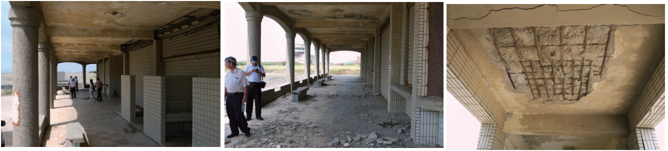
圖 7 海水浴場管理室走廊頂板結構及店鋪設備損壞等情形
