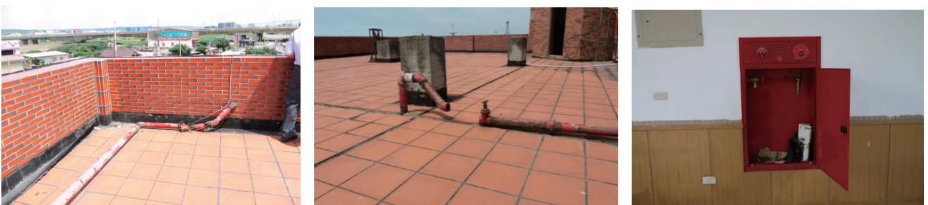
圖6 旅客服務中心消防管線損壞及設備遺失等情形
