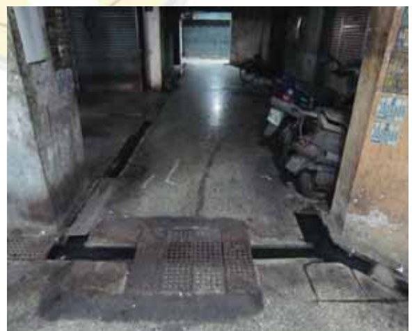
圖 9 民族國宅一樓內排水溝積水情形 資料來源：101 年 3 月 26 日實地拍攝。
