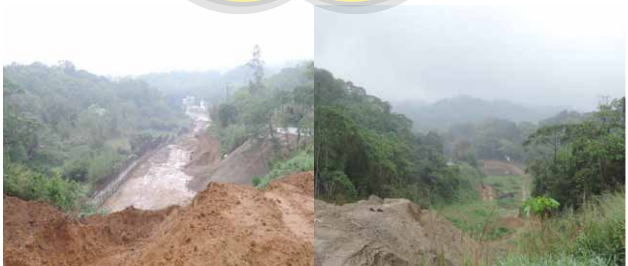
圖4 茄苳聯絡道路改善工程A段第2標部分路段高差過大
