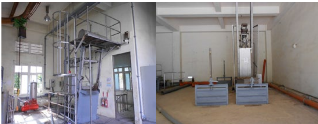
原污水抽水站(粗目攔污柵-新設)
