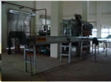
污泥脫水機房(停用)
