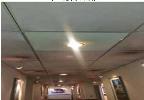
圖 4 阿里山閣大飯店整修前內部 (天花板潮濕)
