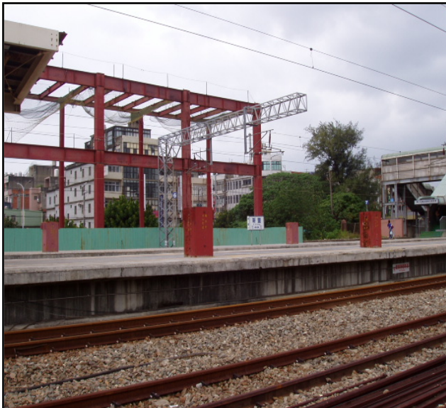
本案原工程工地未清點接管前之閒置情形 (照片來源：99年10月26日現場拍攝)
