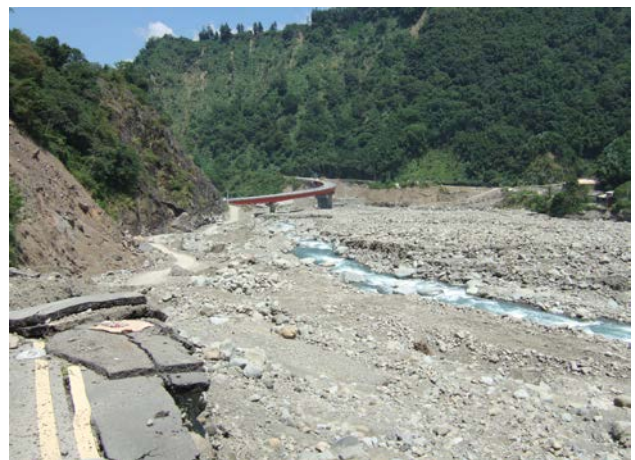
南投縣信義鄉神木村聯外道路災後情形 (南投縣政府提供)
